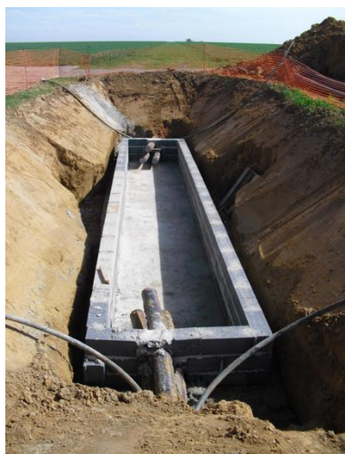
Une chambre de jonction
